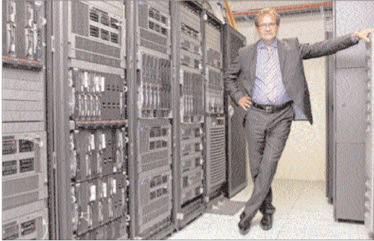
MODERNSTE HARDWARE Centris-Chef Patrick Progin im technischen Herz der Firma, dem Serverraum. HANSPETER BÄRTSCH
